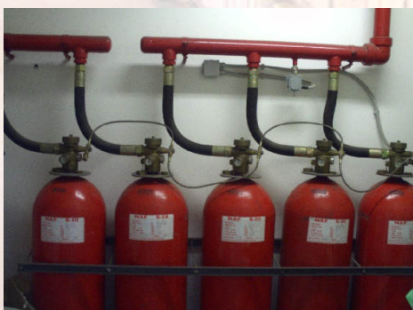
sistema antiincendio automático centralizado
