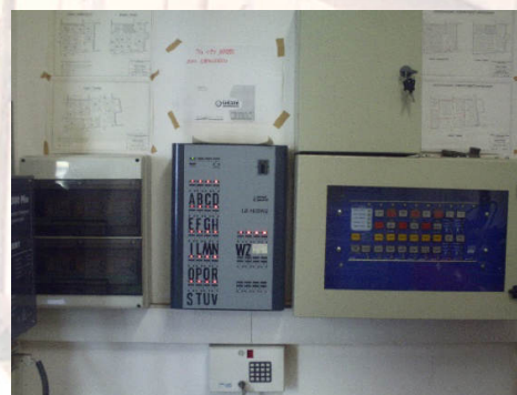
cuadro eléctrico automático centralizado
